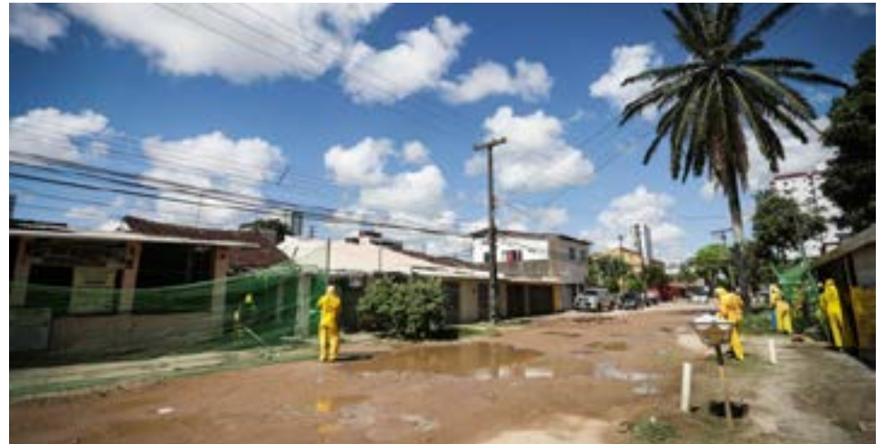
Intervenções nas ruas Desembargador Virgílio de Sá Pereira e Mathuzalém Wanderley, no bairro do Cordeiro, vão melhorar as condições de mobilidade e reduzir os alagamentos na região
